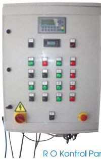
R O Kontrol Paneli
